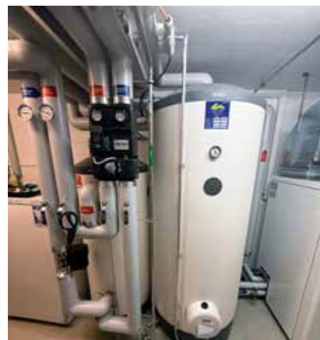
Pufferspeicher mit Heizgruppe für Fussbodenheizung oder Radiatoren
