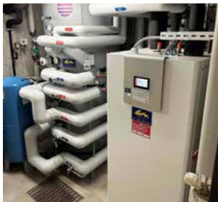
Erdwärmesondenwärmepumpe mit Hygienespeicher für Heizung und Warmwasser
